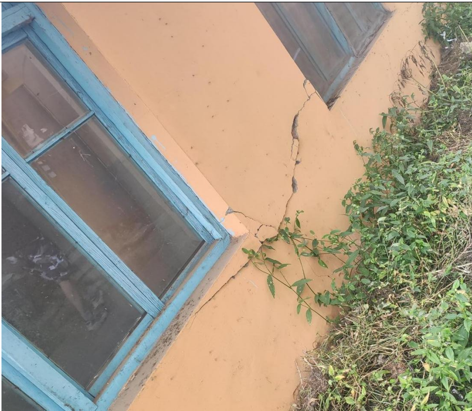
图版 3-10 T3 塌陷区现状房屋开裂
