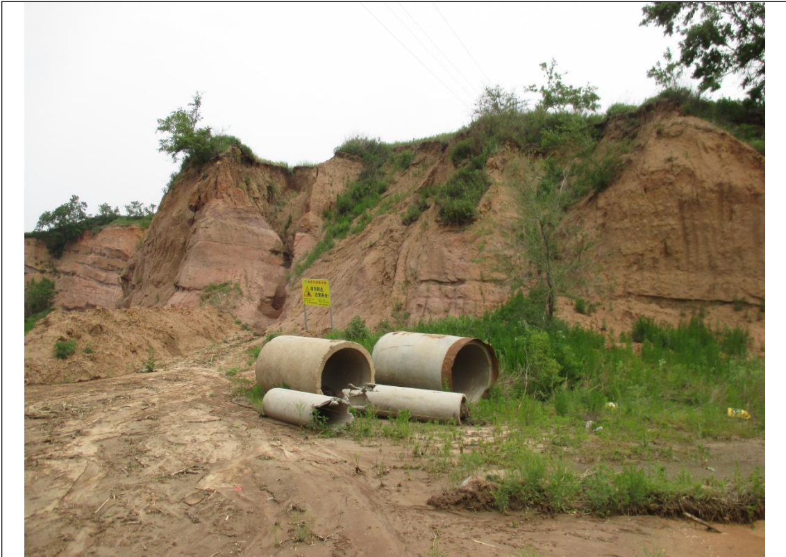
图版 3-3 B2 西靠山屯砂场崩塌地质灾害现状
