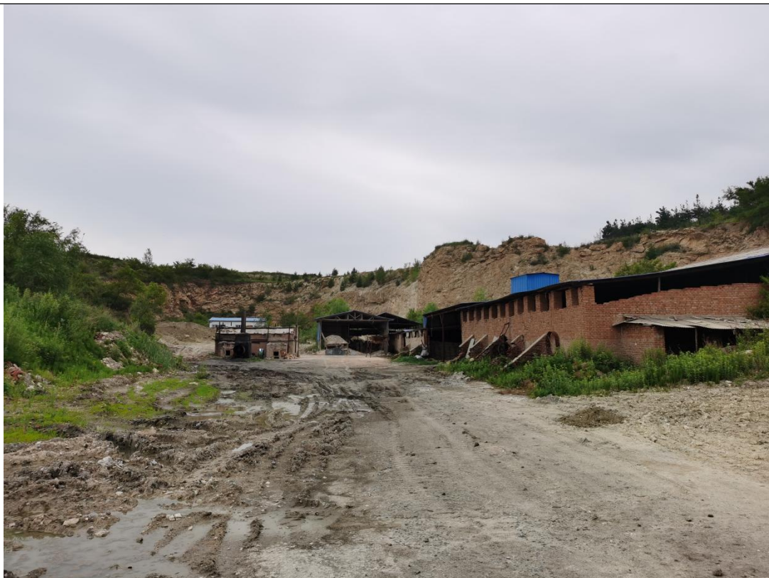
图版 3-2 B1 崩塌地质灾害现状及威胁厂房照片
