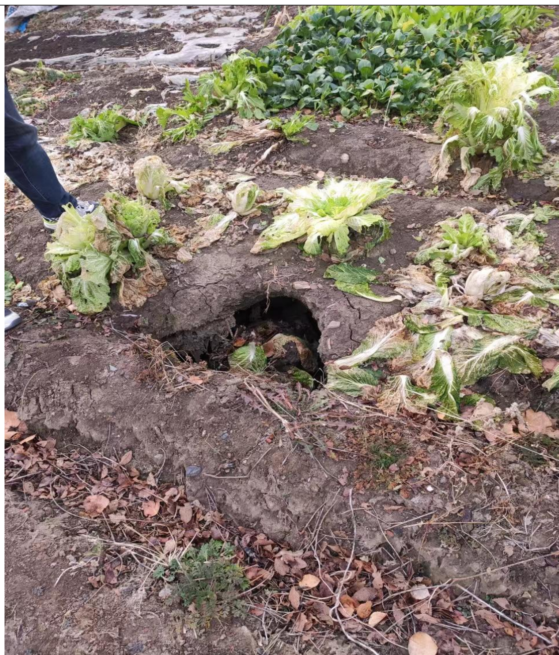
图版 3-18 T8 塌陷区现状
