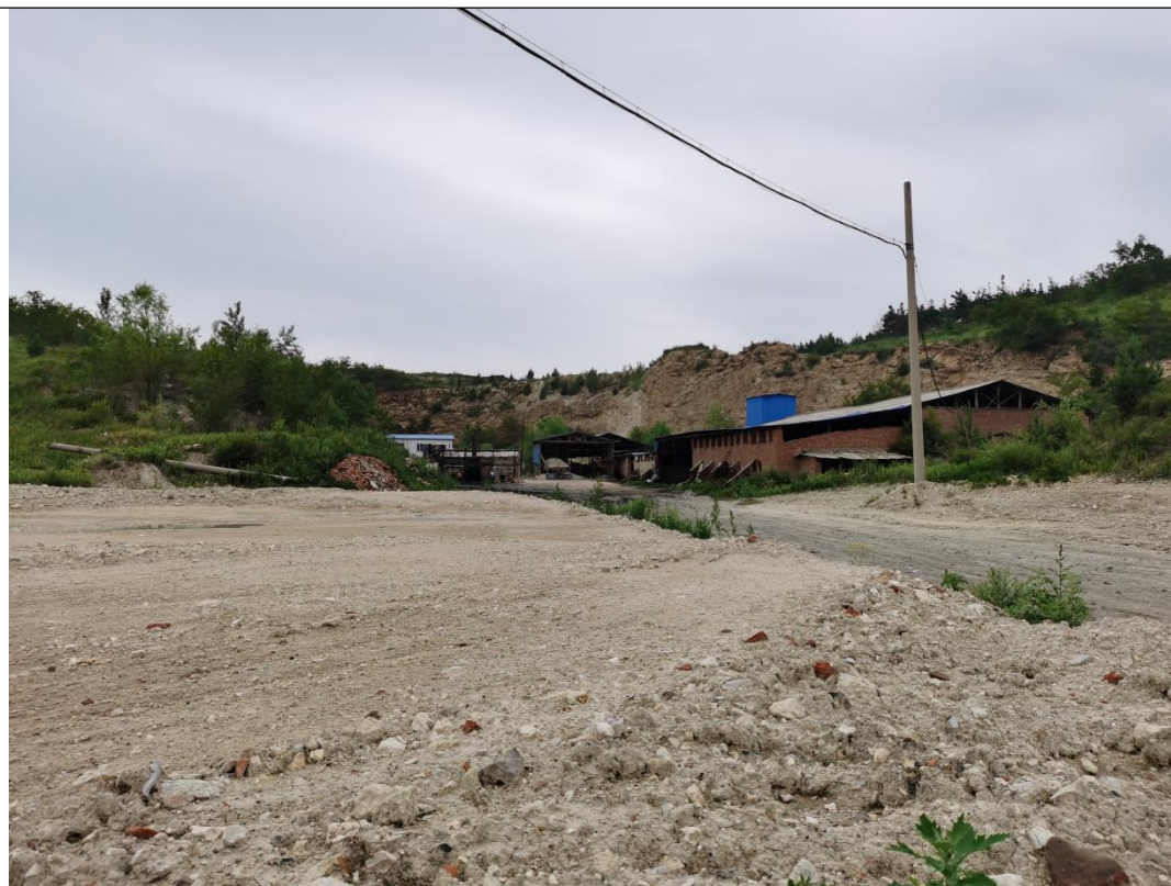
图 3-1 B1 火石岭村贺家沟崩塌地质灾害现状照片
