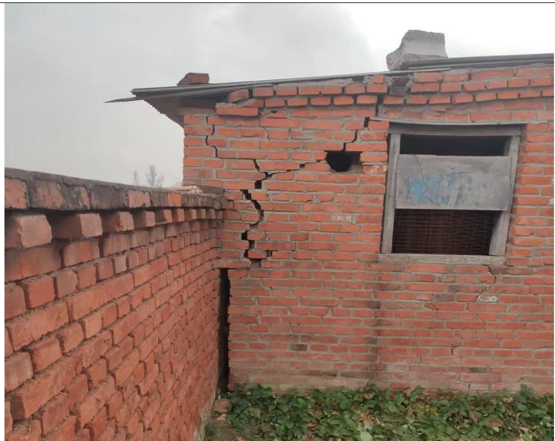
图版 3-15 T6 塌陷区现状
