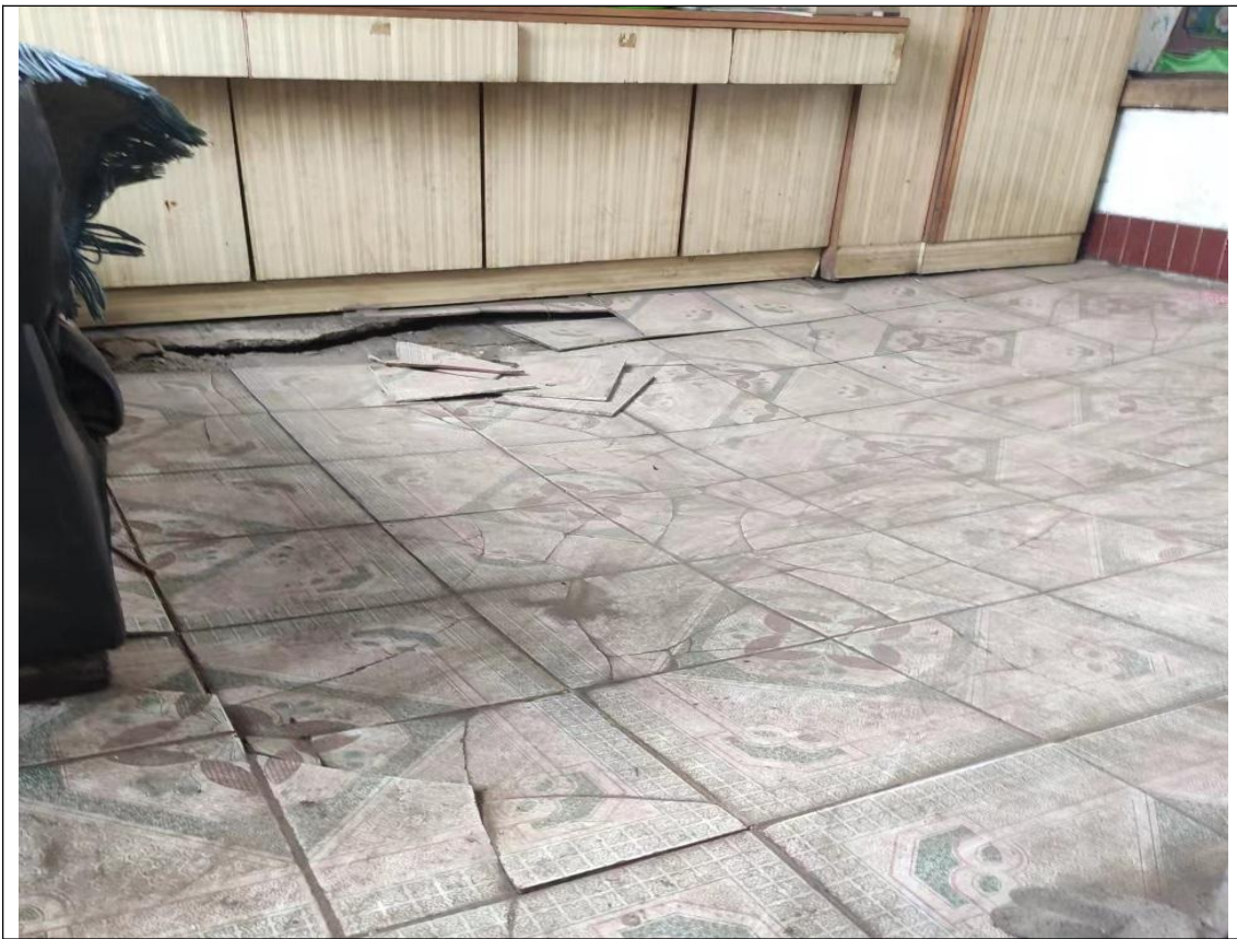
图版 3-16 T7 塌陷区现状
