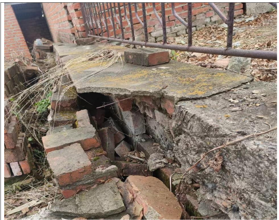
图版 3-15 T6 塌陷区现状
