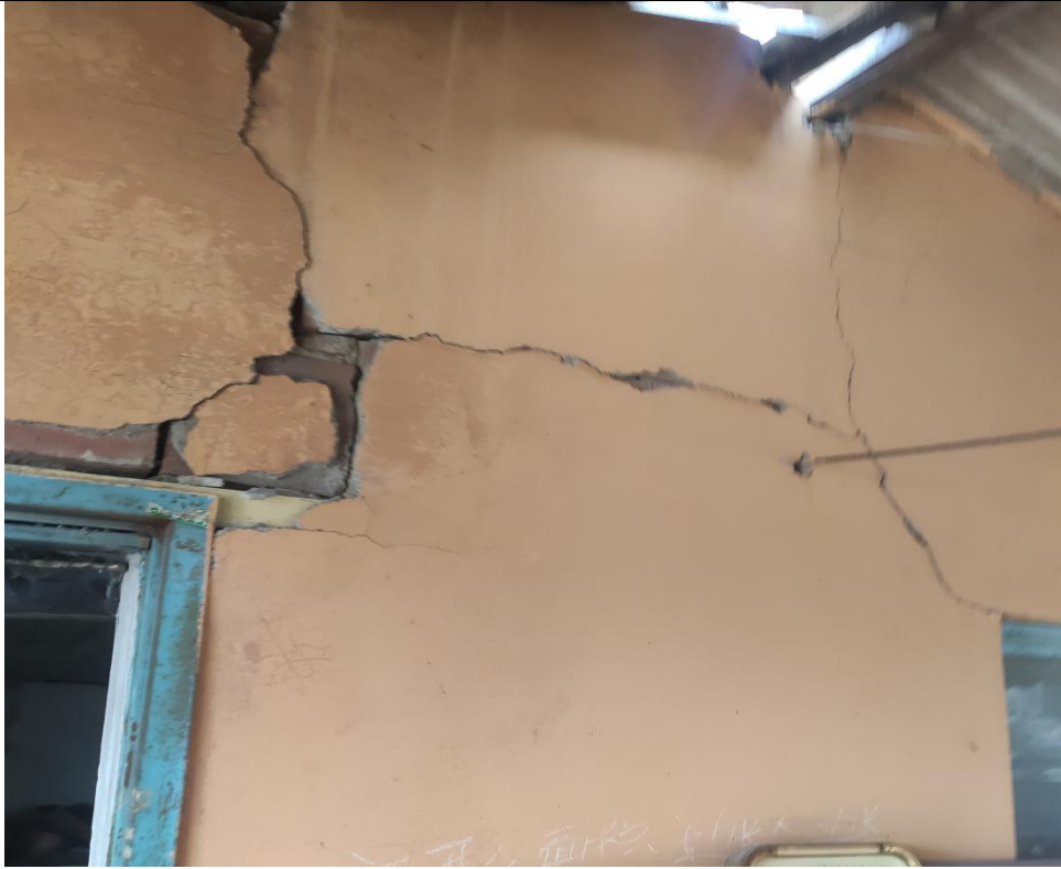
图版 3-9 T3 塌陷区现状房屋开裂
